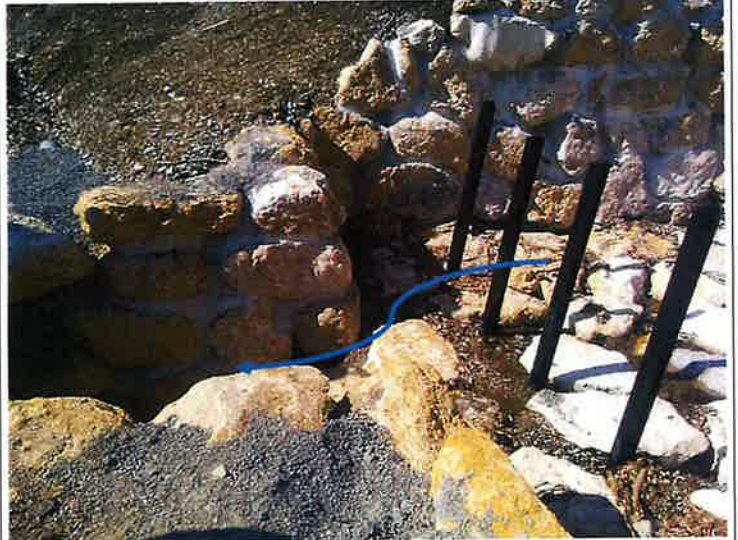
Vue des poutrelles filtrantes
