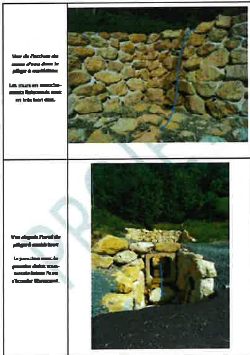
PV de mise à disposition du barrage à aménager des communes de Pichoux St-Julien - Commune du Bouchet-Mont-Charvin
